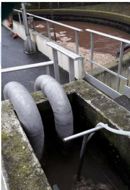
Station d'épuration de Cauvigny
